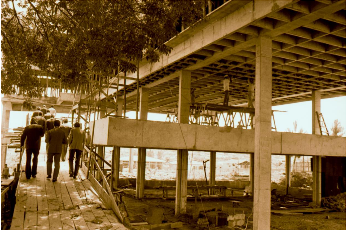
Comitiva em visita, sobe a rampa para o 2º andar da construção do CPD.
