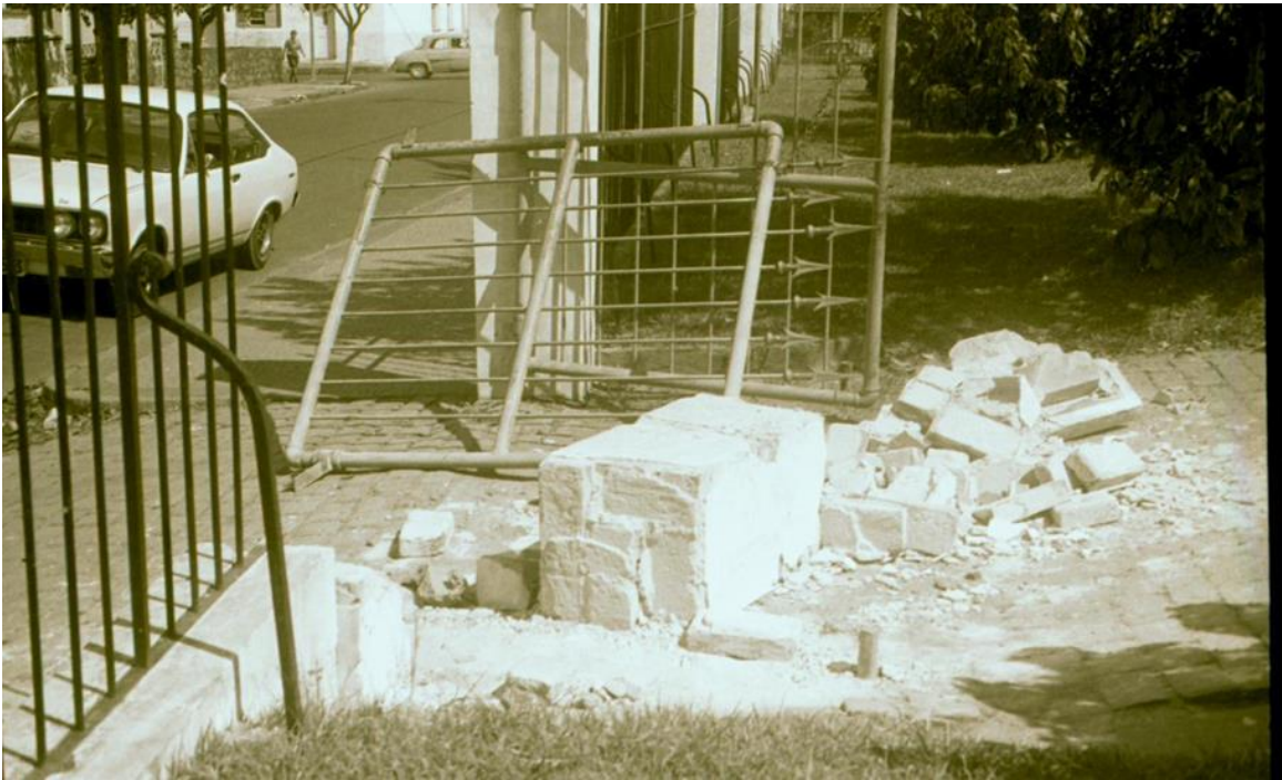
Entrada pela Av. Dr. Carlos Botelho, nº 1465, danificada por um acidente
