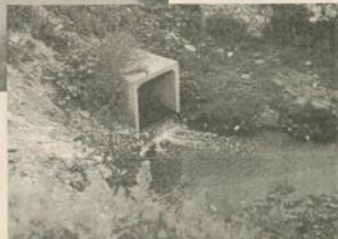
Esgoto é despejado sem tratamento na periferia
