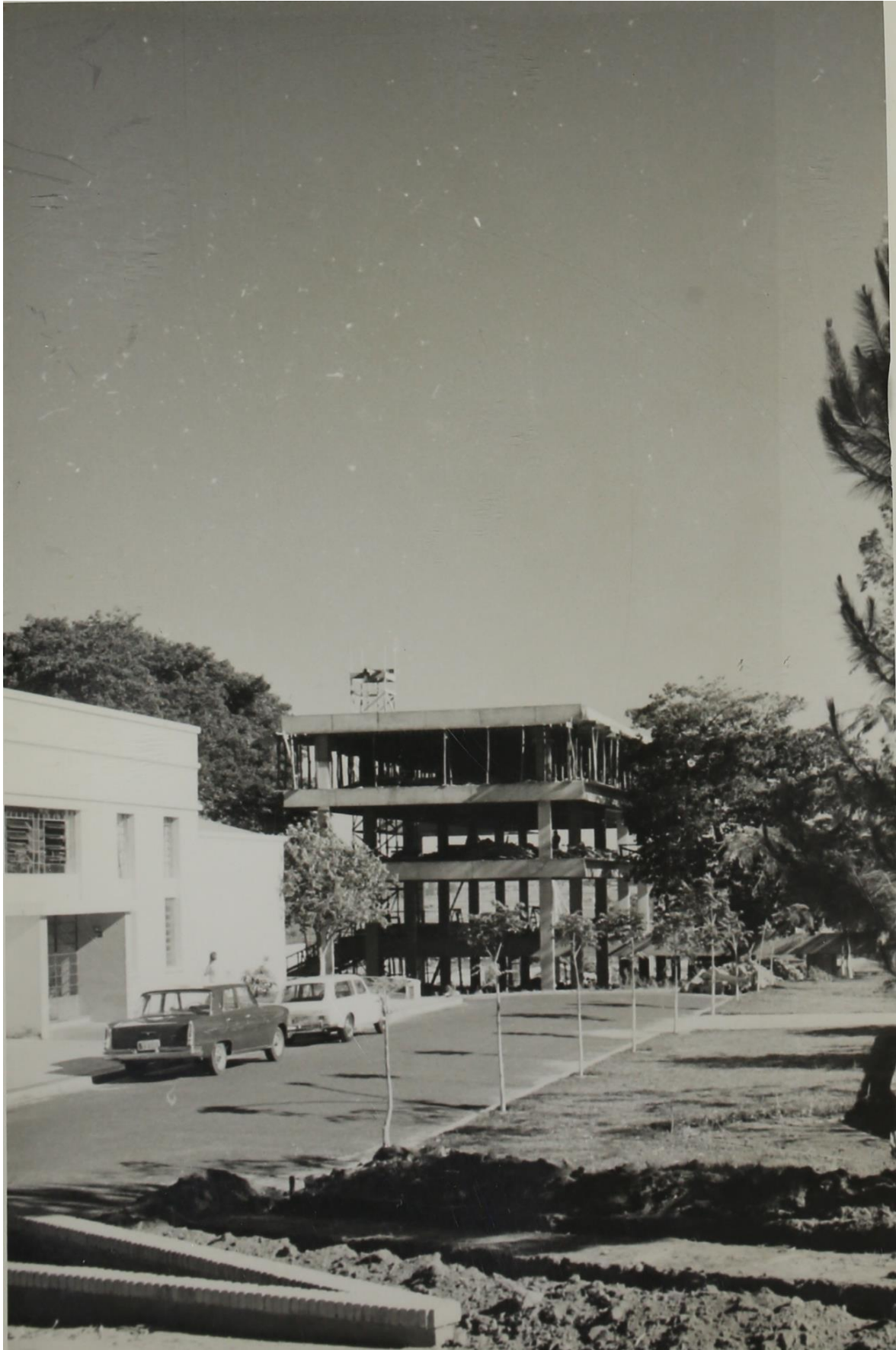
Vista parcial da entrada do Centro de Processamento de Dados e ao fundo seu novo prédio sendo construído.
