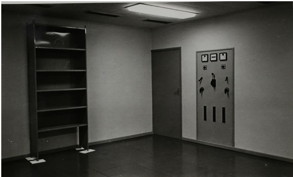
Sala com quadro de energia no CPD, década 70.
